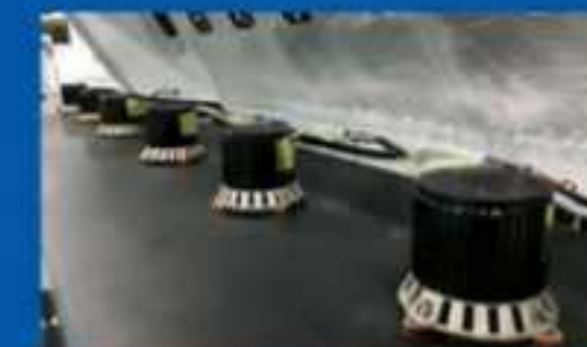
Шесть групп циркуляционных вентиляторов
