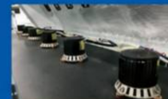
Шесть групп циркуляционных вентиляторов
