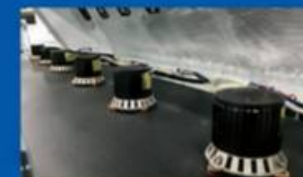
Шесть групп циркуляционных вентиляторов
